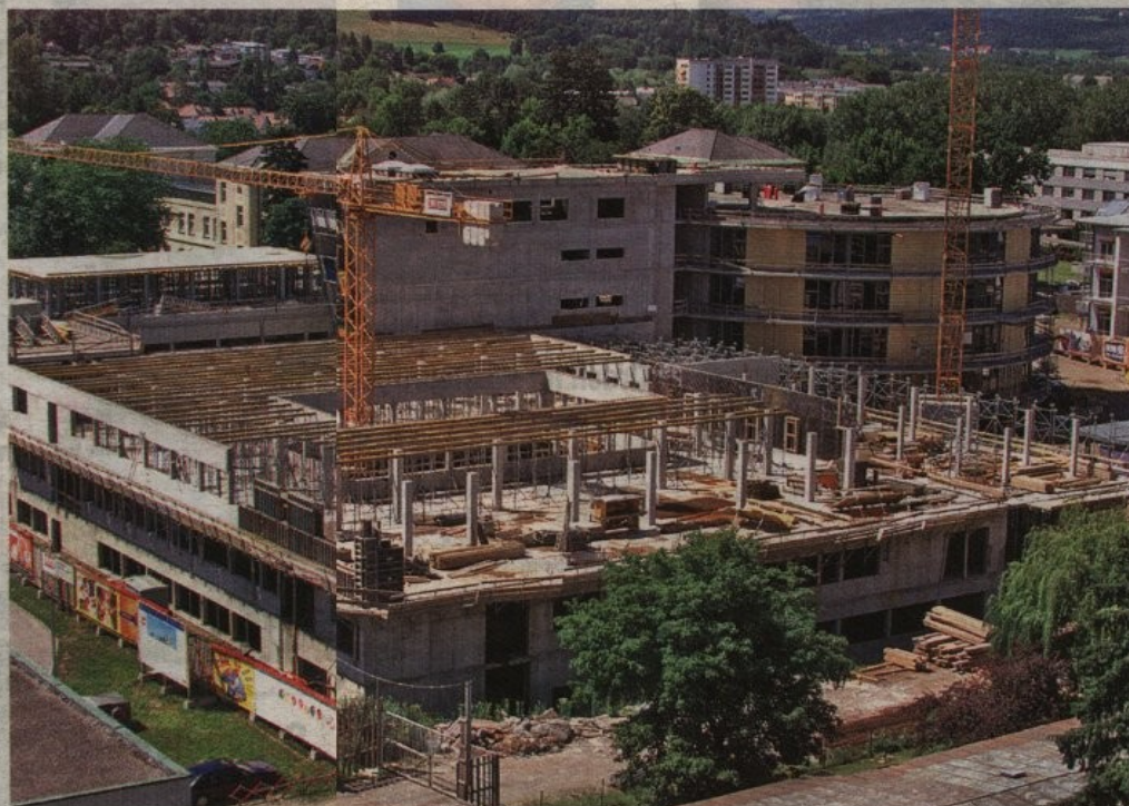
Bei der Errichtung dieses LKH-Gebäudes soll es zu millionenschweren Ungereimtheiten gekommen sein
